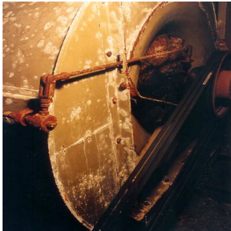
De ventilator na 4 jaar bedrijf in 1992
