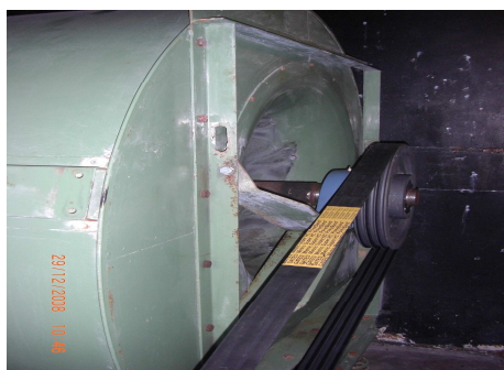
De ventilator 3 maanden na de ombouw. Geen verdere corrosie aantasting.
